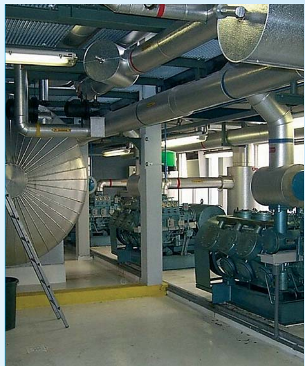
Afbeelding 5 – Deel van de machinekamer van de kunstijsbaan Kennemerland te Haarlem met drie van de vier Grasso-compressoren in het primaire circuit (NH 3 )
